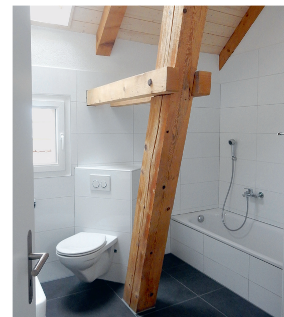
Aufgrund der relativ geringen Rasterabstände der Gebinde sind die Streben teils sichtbar in die Raumgestaltung integriert.
